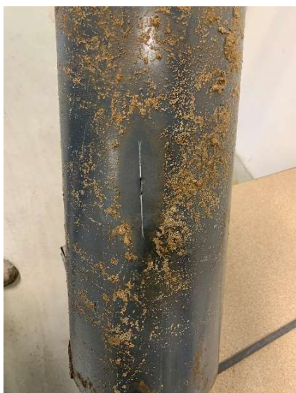
Vandledningen fra vandbruddet på Søndre Ringvej
