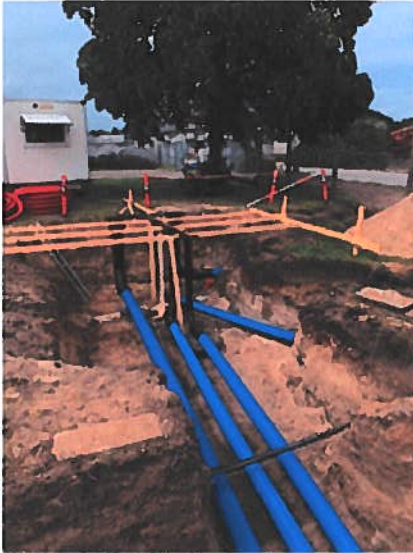
Ledninger under ventilhuset
