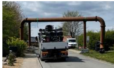
Overpumpningsledning på søparken
