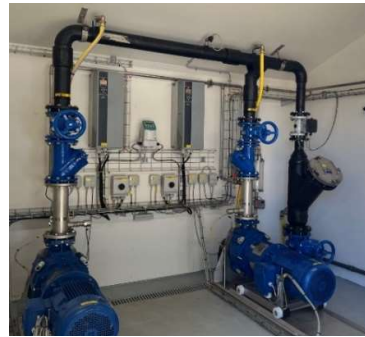
Pumper i pumpehuset ved Lindknud renselanlæg.
