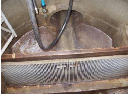
Overløbsbygværk, placeret på Fuglesangsalle, Vejen
