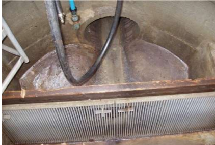
Overløbsbygværk, placeret på Fuglesangsalle, Vejen
