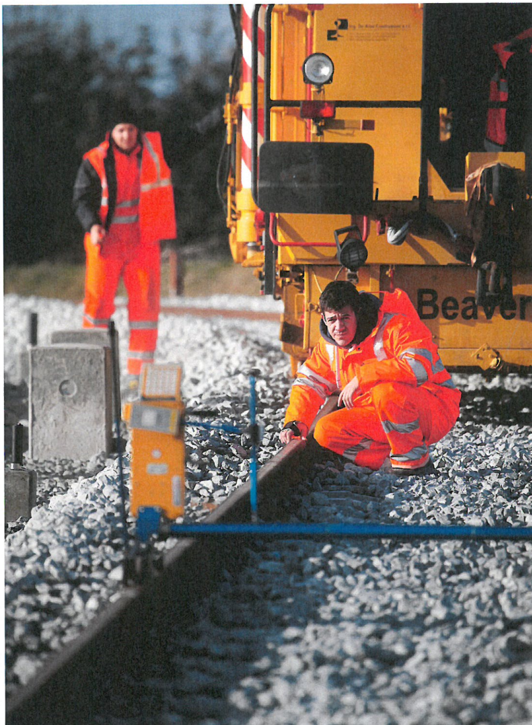
De første skinner er lagt på strækningen fra Lystrup over Lisbjerg til Skejby ved Universitetshospitalet. Sidst på året begyndte arbejdet med at justere sporene på plads. Chili Foto.
