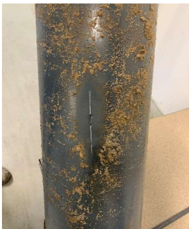
Vandlejningen fra vandbruddet på Søndre Ringvej
