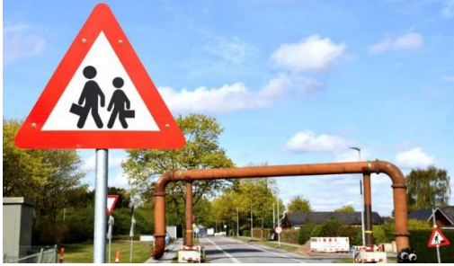
Overpumpningsledning på byagervej
