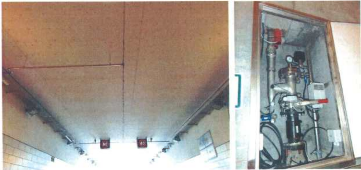
Billeder fra Nordhavnvejens tunnel i KBH, hvor selskabets produkter er installeret i 1,4km vejttunnel.
