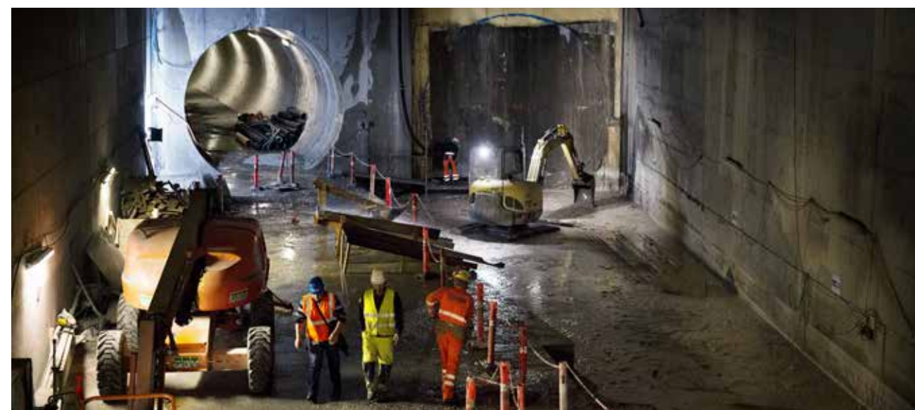
Skakten ved Sønder Boulevard, hvor man kan se afgreningskammetret til kontrol- og vedligeholdelsescenteret ved Otto Busses Vej.
