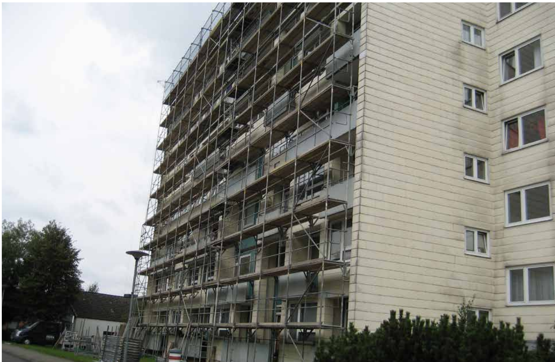
Brandenbaumer Feld 10, Lübeck. En ejendom der er totalsaneret med nyt tag og facade. Investering: 6,6 mio. DKK.
