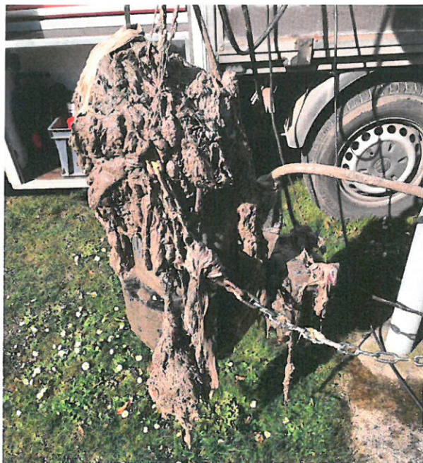
Dykpumpe fra pumpestation dækket af engangsklude og lignende der ikke skulle være skyllet ud i toilettet.
