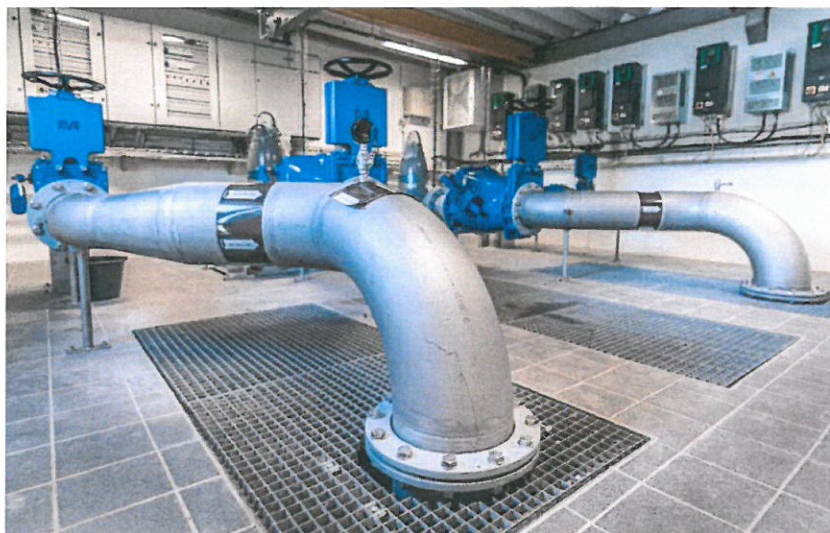
Nye returslampumper til processtanken med tilhørende styring og frekvensomformere.
