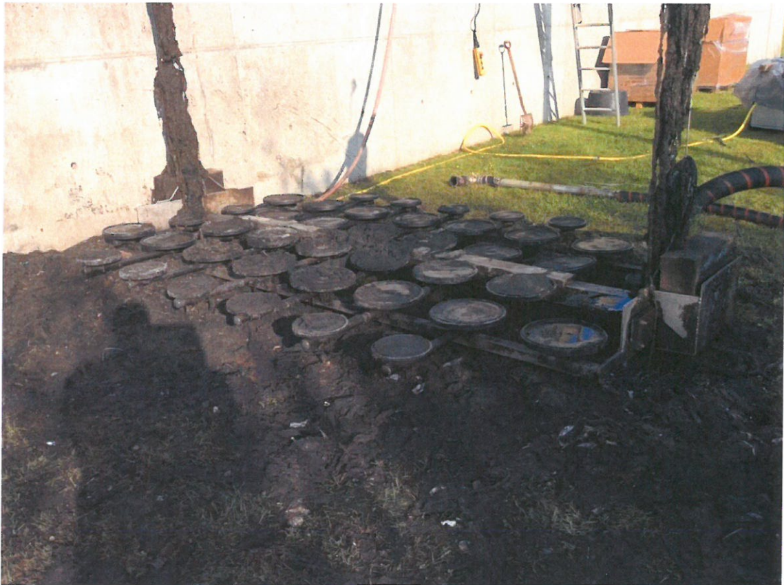
En sektion med tallerken-diffusere er løftet ud af procestanken på Skive Renseanlæg for udskiftning. Der er udskiftet i alt 2.500 tallerkner.
