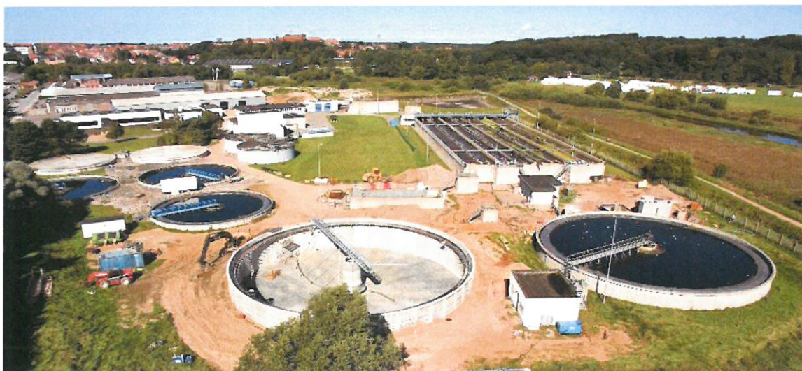
Den nye efterklaringstank ses i forgrunden på billedet. De 3 åbne og de 2 lukkede tanke til venstre i billedet bliver fjernet.
