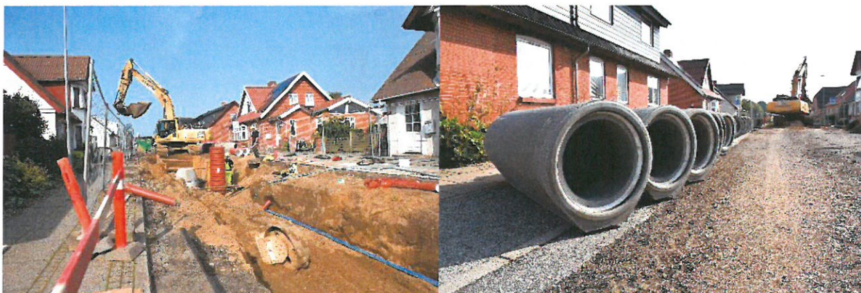
Separatkloakering i Lem. De tynde røde rør på venstre billede er til spildevand og de store grå betonrør på højre billede er til regnvand.
