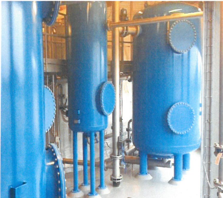
Vihøj vandværk med de blå filterbeholdere og den ene af 2 rustfrie rentvandstanke i baggrunden.
