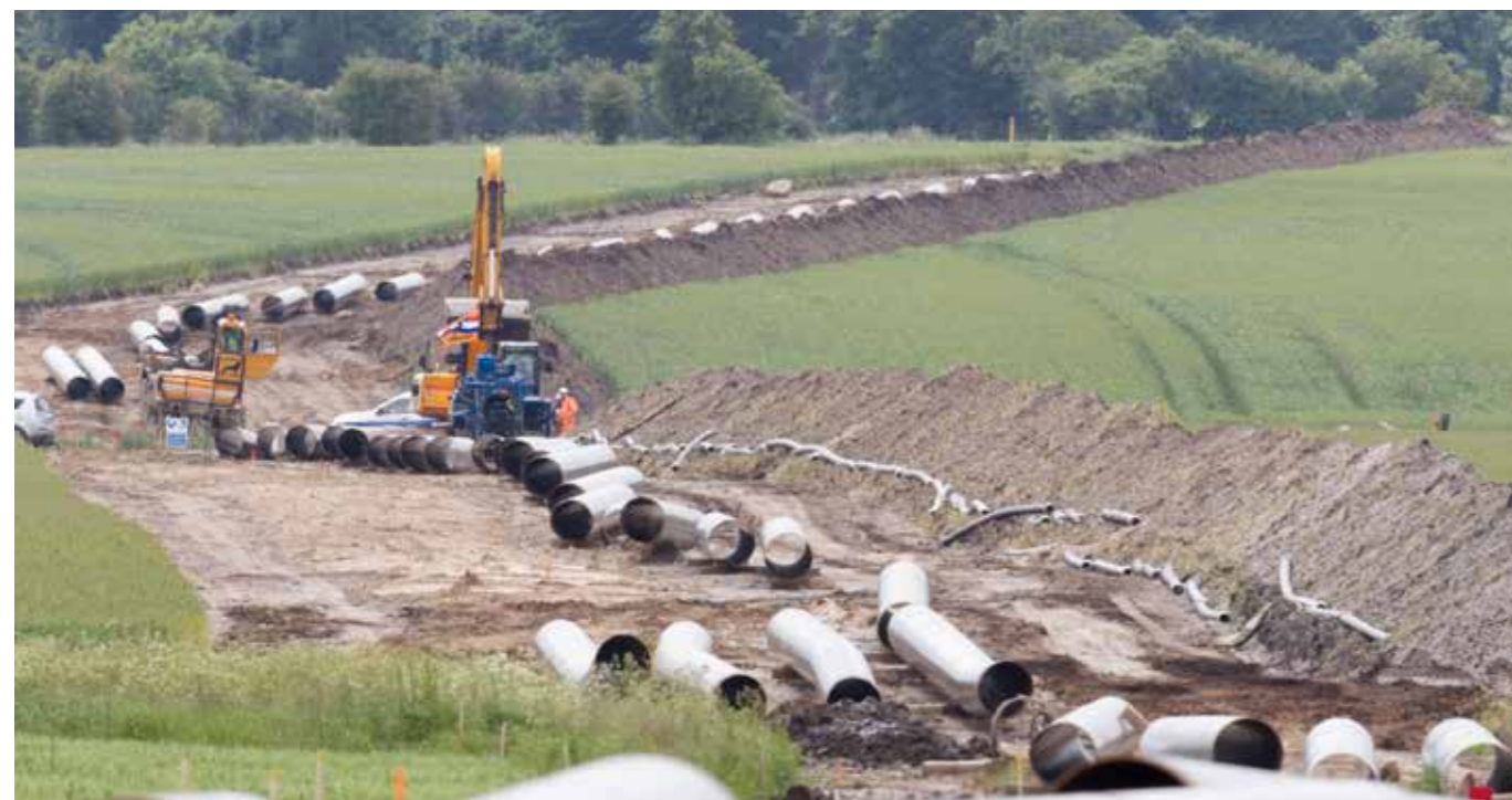
Energinet lægger gasrør i jorden mellem Ellund og Egtved i 2012. Den ekstra gasforbindelse til Tyskland skabte bedre forsyningsikkerhed i Danmark. Det samme vil blive tilfældet for Baltic Pipe, den store gasrørledning til Polen, som i 2017 kom væsentlige skridt tættere på realisering.
