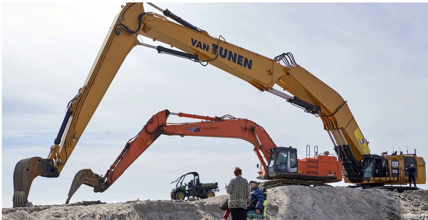
Havnebyggeriets store maskiner blev vist frem for borgerne under eventen: Åben Byggeplads.
