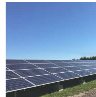
HOFORs solcellepark ved Kikkenborg syd for Lemvig.
