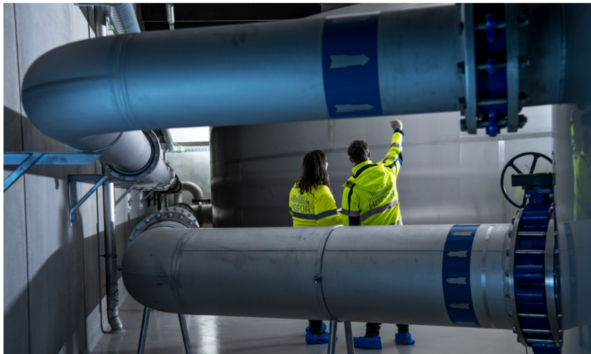
Værket ved Marbjerg begyndte at levere blødgjort vand i 2021.
