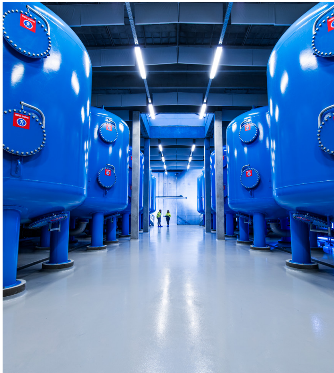
Vandtanke på Værket ved Marbjerg, der begyndte at levere blødgjort vand i 2021
