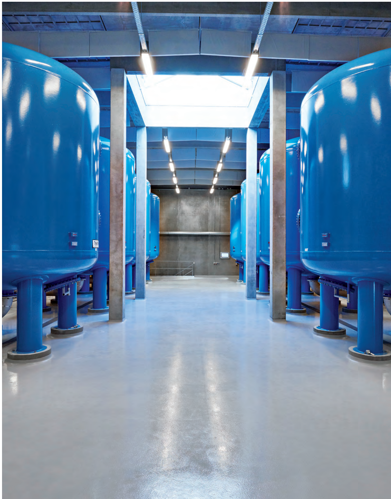
Da Vandværket ved Marbjerg åbnede i marts 2015 var det med stor bevågenhed fra både ind- og udland.
