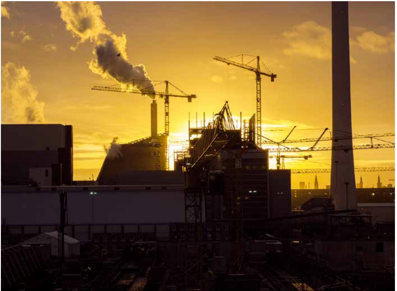
På Amagerværket er byggeriet af en ny kraftværksblok i gang – et byggeri som følger både budget og tidsplan.
