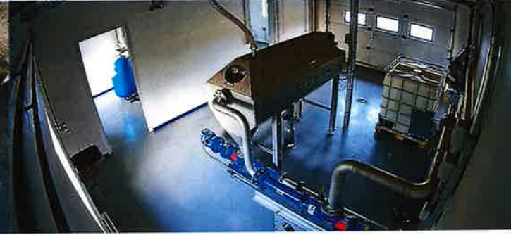
En del af processerne foregår i maskiner og tanke over jorden og i bygninger. Her kan kameraerne være med til at se eventuelle brud eller lækager fra installationerne, som ellers ville kunne stå ubemærket i længere perioder.
