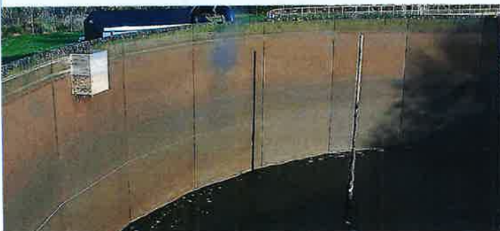
Under kraftig regn bliver udligningstanken taget i brug, da renseanlægget ikke kan følge med. Her kan vi se, om der er overløb fra tanken. Ligeledes kan vi se, når tanken er tom, om der er brug for rengøring. Noget som før krævede en fysisk inspektion.
