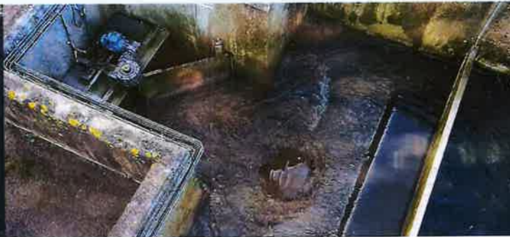
Her ses fordelerspældet, som bestemmer hvilken proces tank vand og returslam skal i. Begynder tallene ikke at stemme overens med forventningerne til processen, kan det f.eks. skyldes, at spældet er defekt eller står forkert eller ganske enkelt, at returslumpumpen ikke virker. Alle sammen situationer vi har oplevet før og har kaldt på fysisk inspektion. Dette kan nu foretages med et kig med kameraet.
