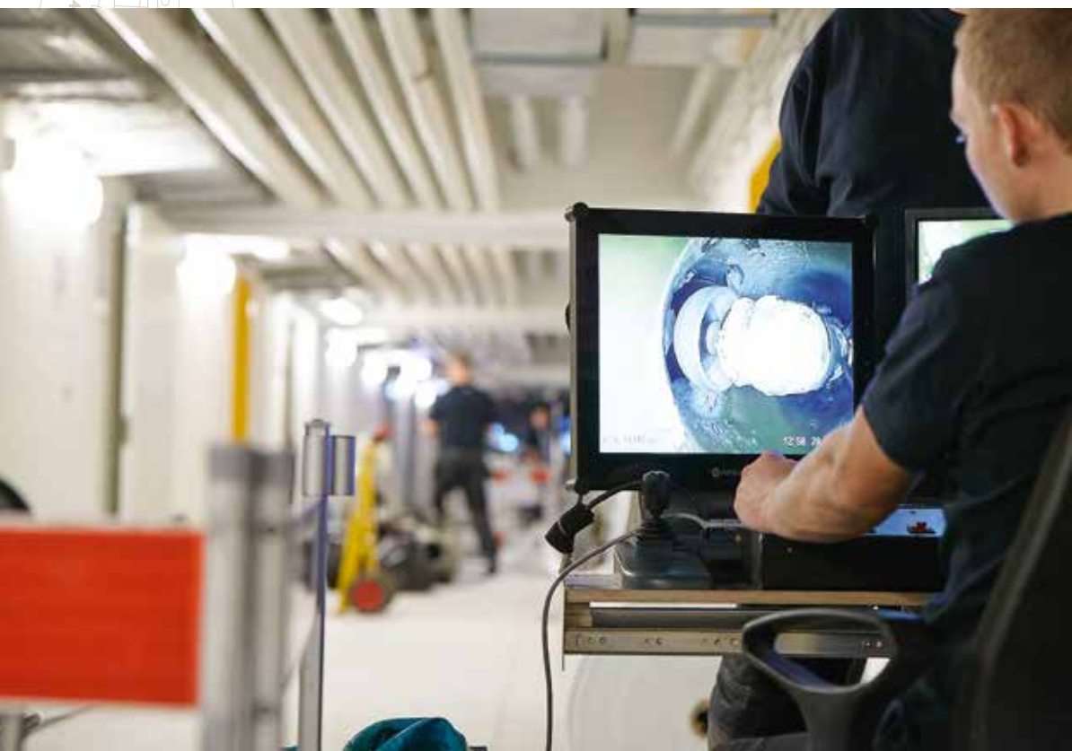
På Aarhus Universitetshospital i Skejby er Aarsleff begyndt på første etape af en fireårig renoveringsplan, som skal sikre et velfungerende kloaksystem.
