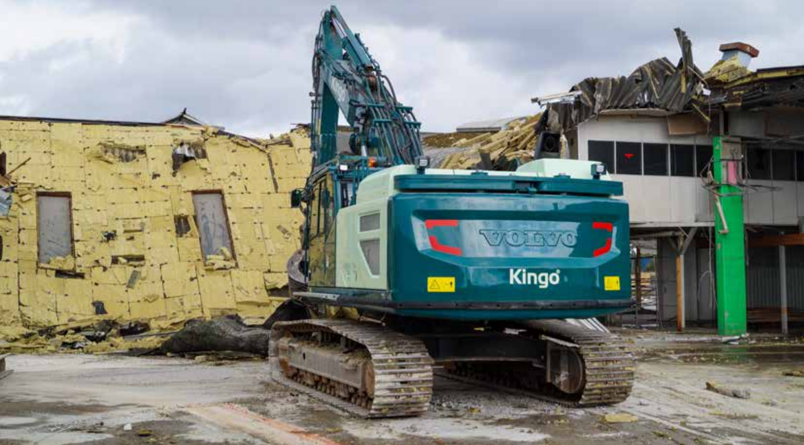
Totalnedbrydning af lagerhaller og garager hos Gasa i Tilst.
