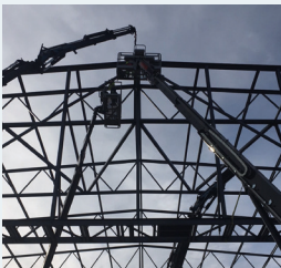
Sikkerhed i detaljen DATA CENTRE
