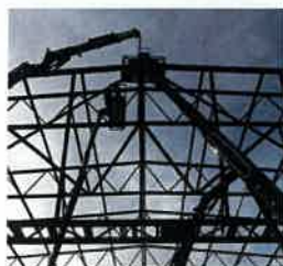
Sikkerhed i detaljen DATACENTRE
