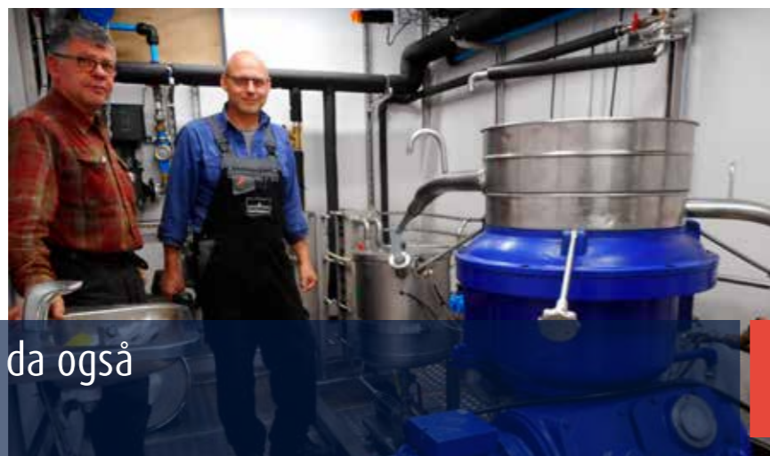
Royal Greenlands projektleder Søren Søndergaard og Peter Assenbjerg fra Energy Technic ved anlæggets centrifuge
